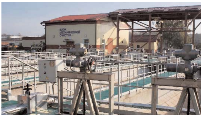
Блок механической очистки
