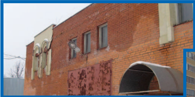
Станция обезжелезивания п.Львовский – многочисленные протечки воды с крыши здания по стенам, с образованием наледи.
